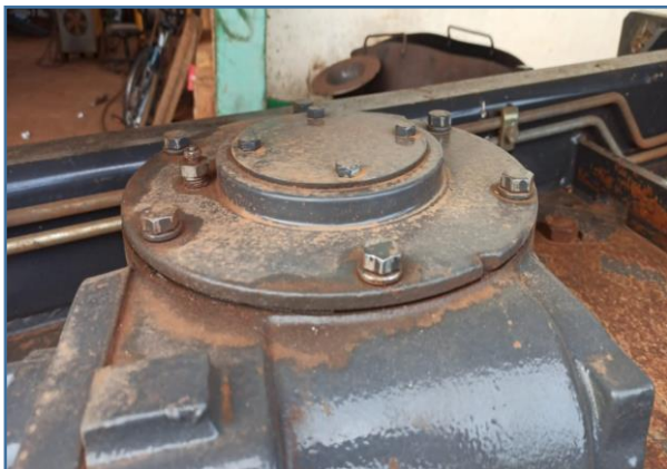
IMAGEM DE VAZAMENTO NO REPARO DA TAMPA DO GIRA CÍRCULO
