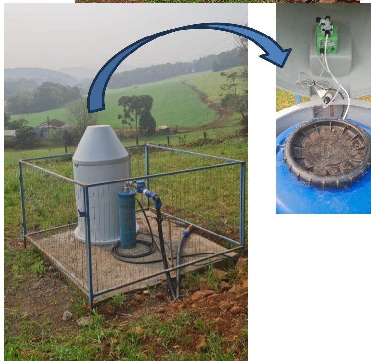
Sistema de tratamento de água instalado junto ao poço tubular
