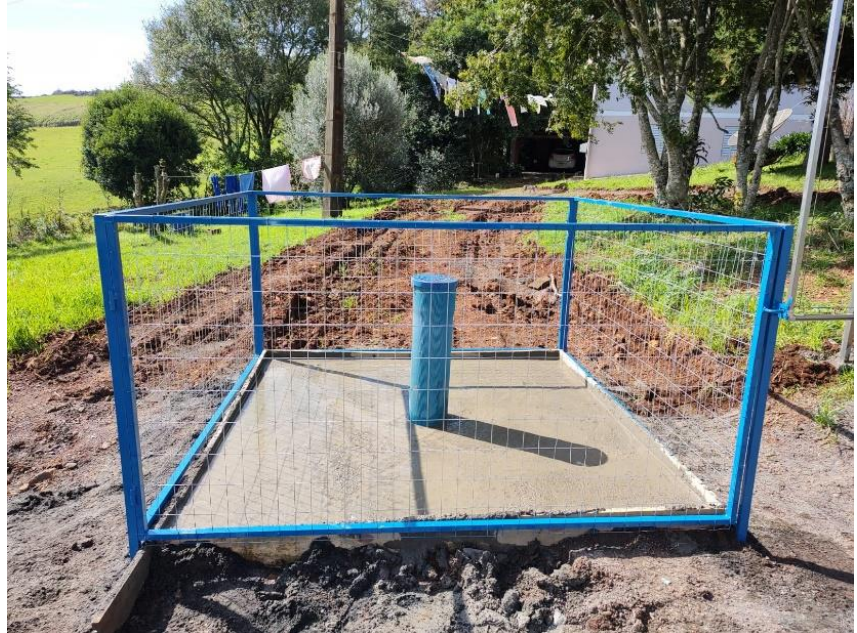
Poço tubular instalado com cercamento e base de proteção
